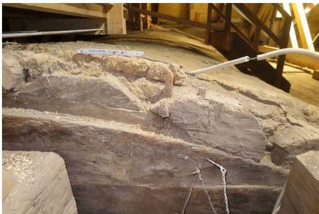
Goslar, Rathaus. Ratsstube, Deckenkonstruktion. Blick nach Westen. Östliche Bohlenwand und mit dieser verkämmte und verdollte Deckenbohlen. Zur Dämmung sind Lehm packungen aufgebracht. Foto: Eißing 2019
