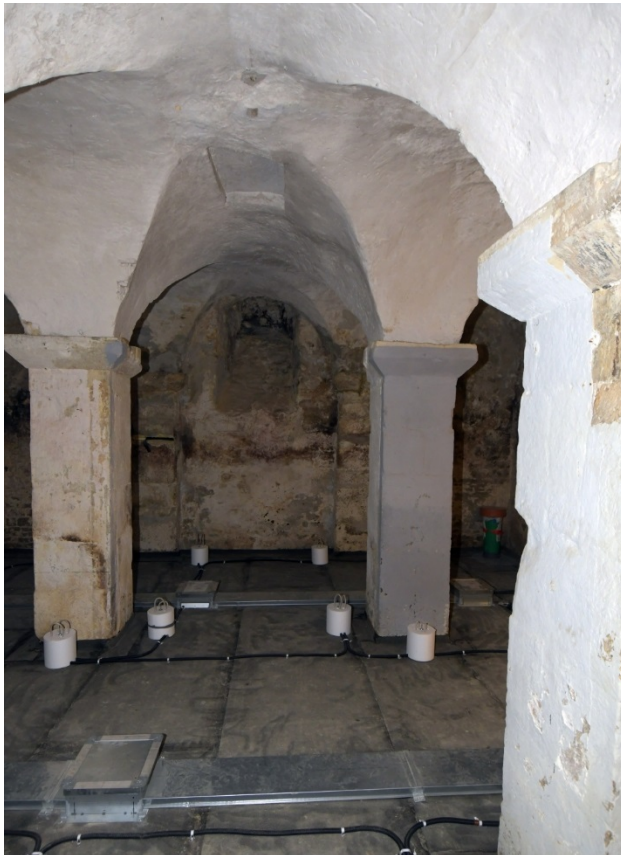
Goslar, Rathaus, Südwestflügel. Kellergeschoss, Blick nach Westen. Neunfeldriger quadratischer Grundriss mit Pfeilern und Kreuzgratgewölbe. Foto: Eißing 2020
